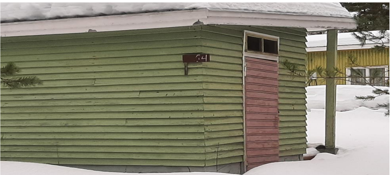
Pyykösen talousrakennus, likimain alkuperäisessä kunnossaan; sokkeli poikki monesta kohdasta.
