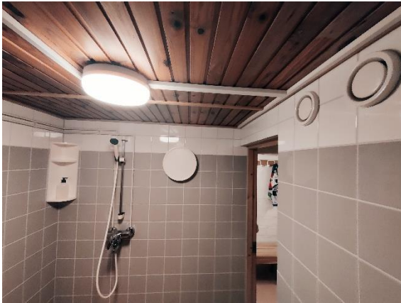
Märkätilan poistoilmanventtiilit ja siirtoilmanventtiili
