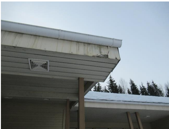
Vanhan osan julkisivujen yläosissa käytetyissä kivilevyissä jonkin verran mekaanisesta rasituksesta aiheutuneita vaurioita ja tummentumaa (levy saattaa sisältää asbestia)
