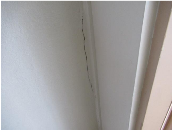
Halkeama vanhan osan länsipäädyn ulkoseinän sisäkuoressa
