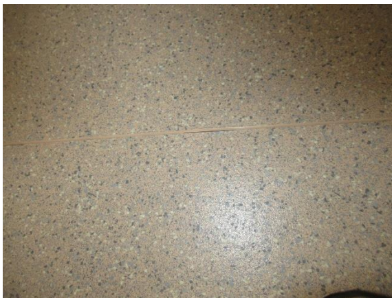
1. kerroksen pesuhuoneen lattian muovimaton saumassa halkeama
