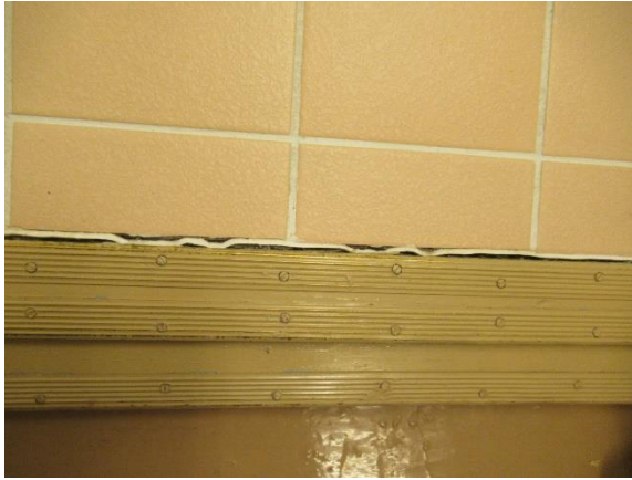
Kellarikerroksen märkätilan lattian elastiset saumat ovat vaurioituneet
