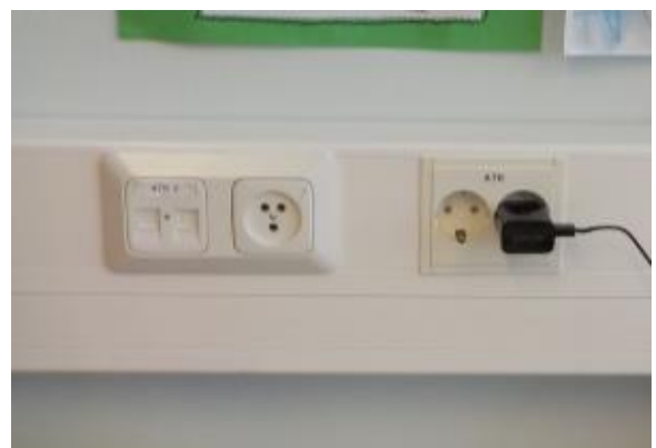
Yleiskaapelointirasia luokassa olevassa johtokanavassa
