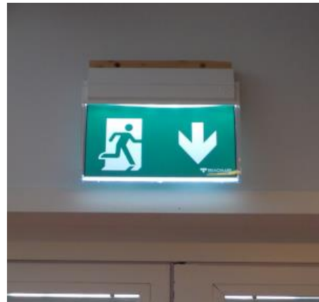
Poistumisvalaisin oven päällä
