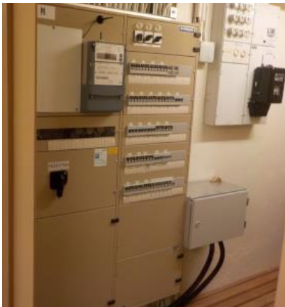
Pääkeskus, laajennusosa sekä vanha ryhmäkeskus pääkeskushuoneessa
