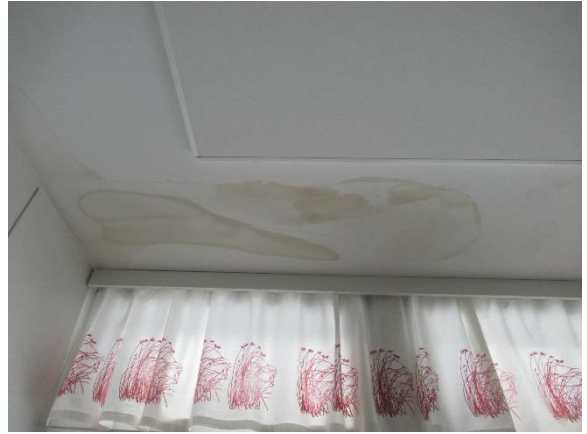
Vanha vuotojälki kanslian sisäkatossa
