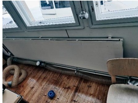
Lämpölinjat kulkevat pinnassa lämmityspattereiden alla
