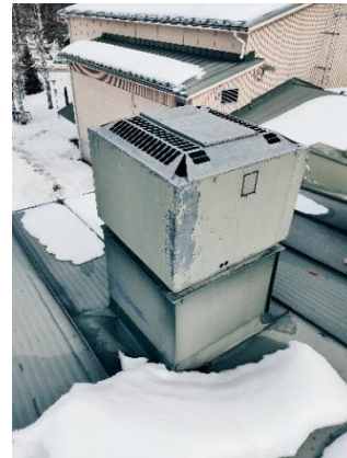
PK2 keittiön poistoilman huippuimuri
