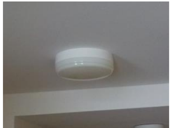
Pinta-asennettu valaisin käytävällä
