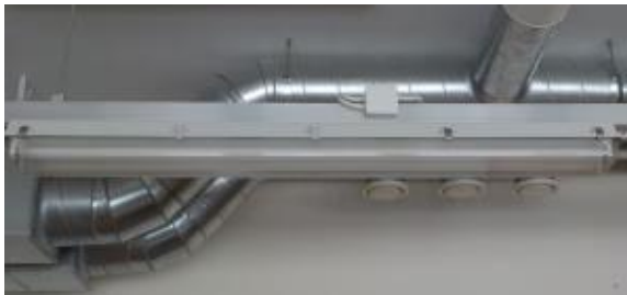
Valaisin ripustuskiskoon asennettuna teknisen-työn tilassa
