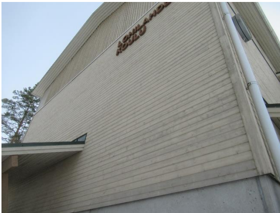
Julkisivujen puuverhouksissa tummentumaa ja jonkin verran haristumaa
