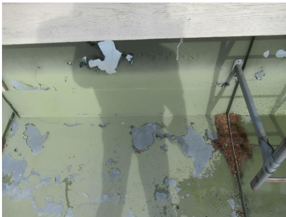
Pinnoitevaurioita vesikatteessa ja suojaPELLITYK- sessä
