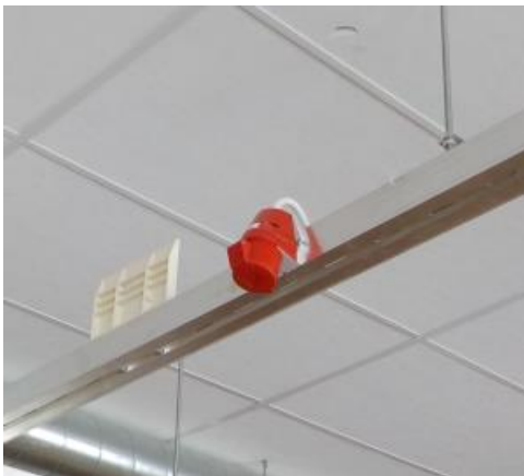
3~pistorasia valaisinripustuskiskoon asennettuna teknisyön tiloissa
