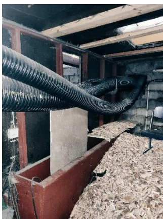
KPA-kattilalta tulevat lämpöjohdot kiinteistöön kellarikerroksessa.
