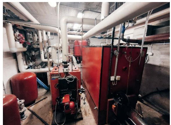
Öljykattilat ja lämmityksen sunttiryhmät sekä paisunta-astiat
