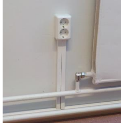
Kaapelointia rasialle asennuslistalla
