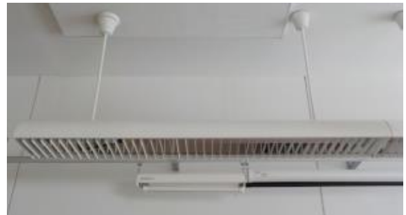
Ripustettu valaisin luokassa
