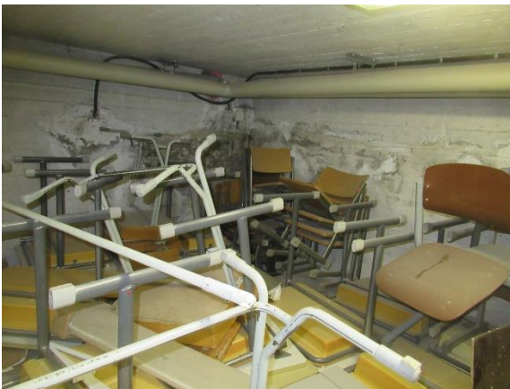
Kosteusjälkiä vanhan osan kellarikerroksen entisen polttoainevarastotilan seinässä
