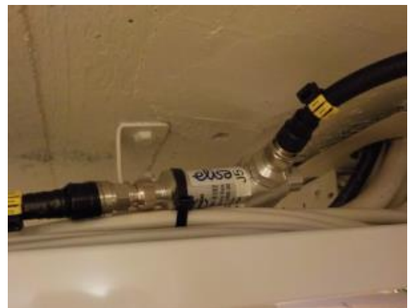
Operaattorin sisäverkon kaapelointia kellarissa
