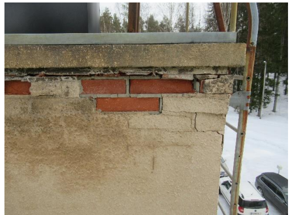
Piipun yläosan vaurioita
