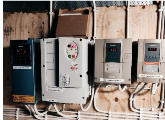
IV-koneiden puhaltimien taajuusmuuttajia
