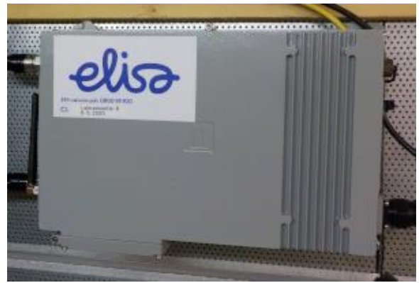
Mobiilioperaattorin sisäverkonlaite IV-konehuoneessa
