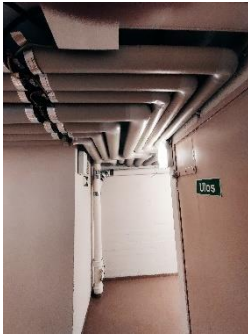
Kellarikerroksessa kulkevia lämpöjohtoja
