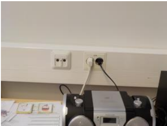
Kaapelointeja ja rasiointeja johtokanavassa
