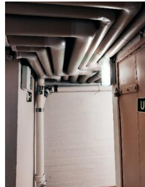
Kellarikerroksessa käyttövesiputkistoja ja alkuperäinen valurautaviemäri seinustalla.
