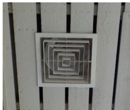
Kattovalaisin uppoasennuksena sisäänkäynnin lipassa
