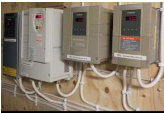
Taajuusmuuttajien sähköistys IV-konehuoneessa
