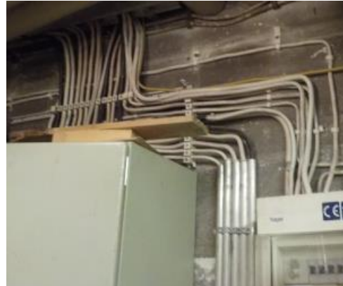
Kaapelointeja johtokiinnikkeillä, Niedax-kiskolla sekä putkittamalla
