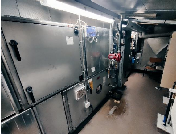
TK3 liikuntasalin ilmanvaihtokone
