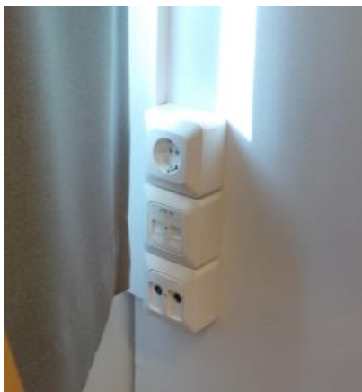
Rasiointeja pinta-asennuksena huoneessa
