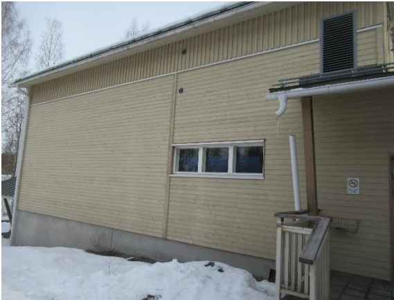
Laajennusosan syöksytorvi irrotettu jäätymisen takia
