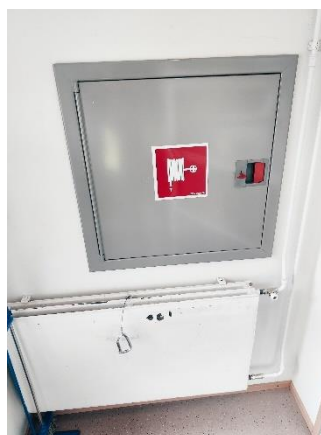
Kolhiintunut tuulikaapin patteri
