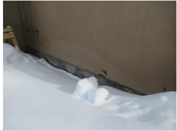
Vanhan osan päädyssä kallistukset rakennukseen päin
