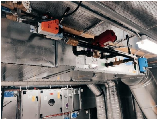
TK2 keittiön tuloilmakone
