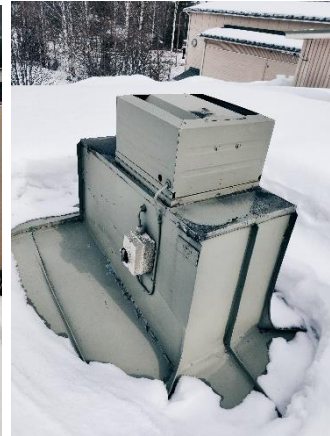
Vesikatolla WC huippuimuri
