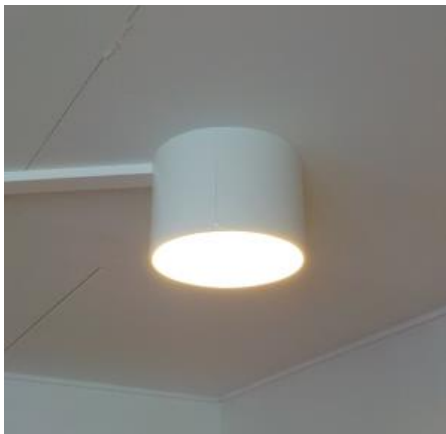
Pinta-asennettu valaisin käytävällä
