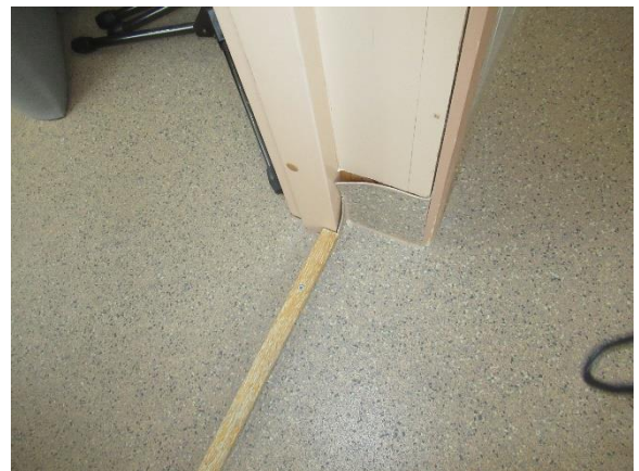
1. kerroksen pesuhuoneen lattian muovimaton ylösnostot ovat irronneet
