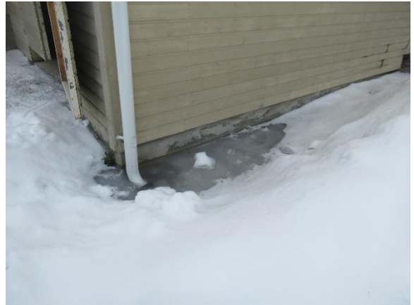
Vanhan osan vierustalla olevan varaston vierelle kertyy sulamisvesiä, samoin laajennusosan kellarikerroksen ulko-ovien edustalle
