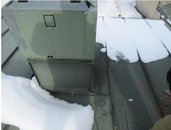
Pinnoitevaurioita vesikatteissa ja suojaPELLITYKSISÄÄ
